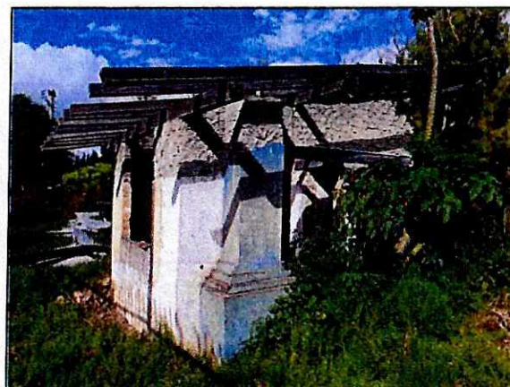
M11 – CONSTRUCCIÓN EN RUINAS
